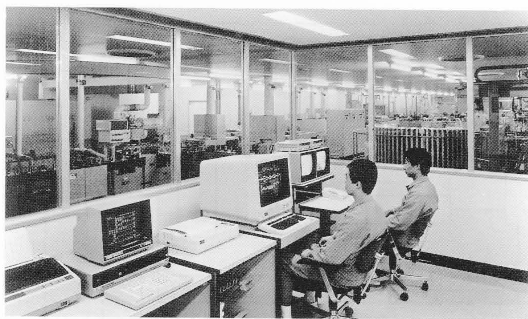
図5 中央監視室 カラーグラフィックCRT(写真中央部)で工程全体の管理が可能である。
