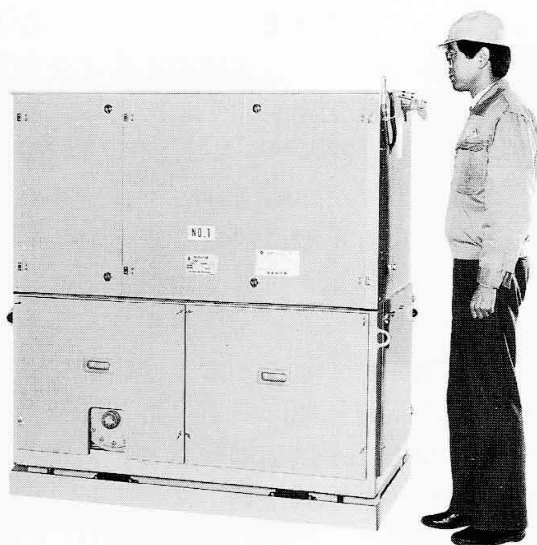
図2 マイクロコンピュータ制御による油圧パワーユニット
