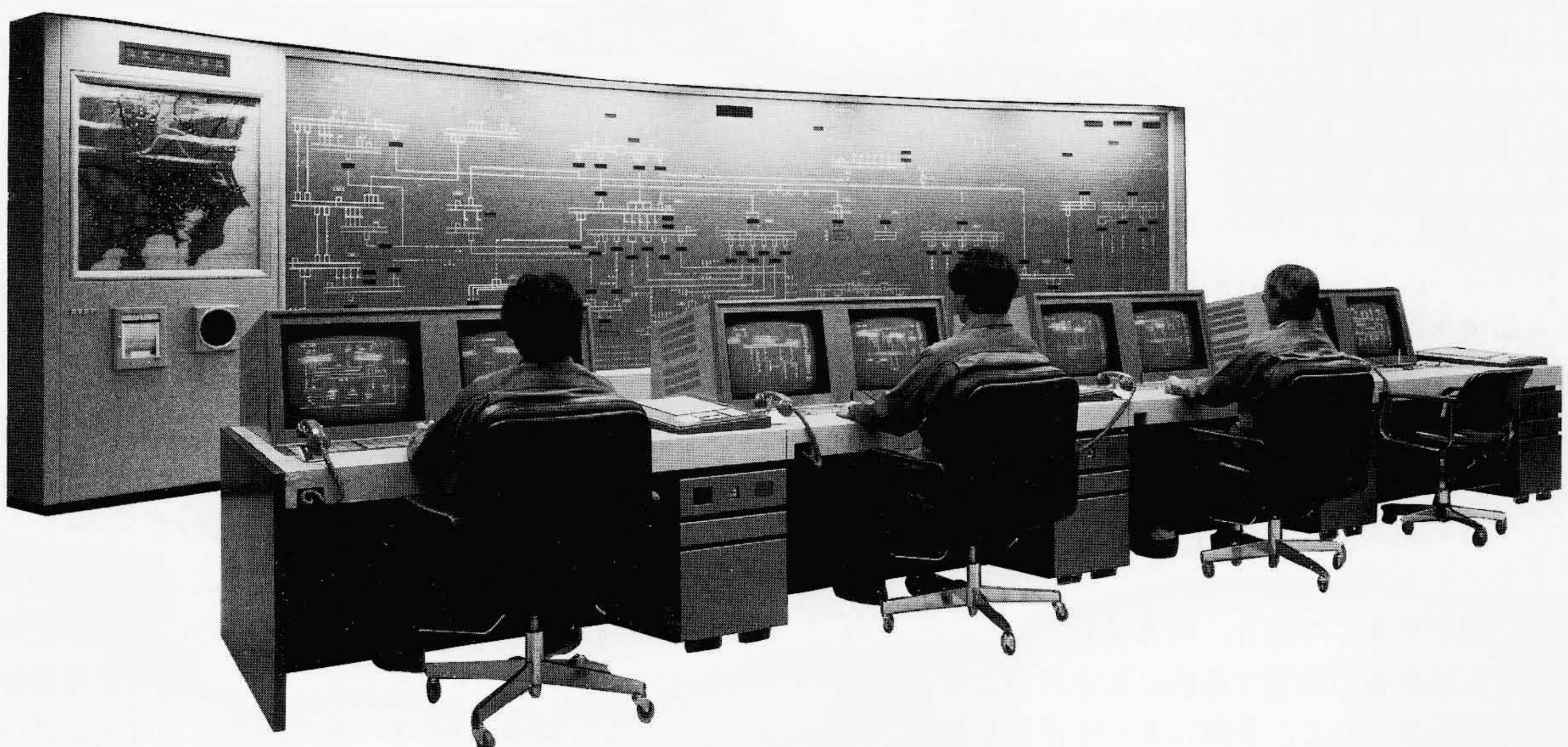
図3 東京電力株式会社大島給電所指令室 同一機能の指令台が4卓並んでいる。系統盤，気象情報表示盤は計算機により駆動されている。
