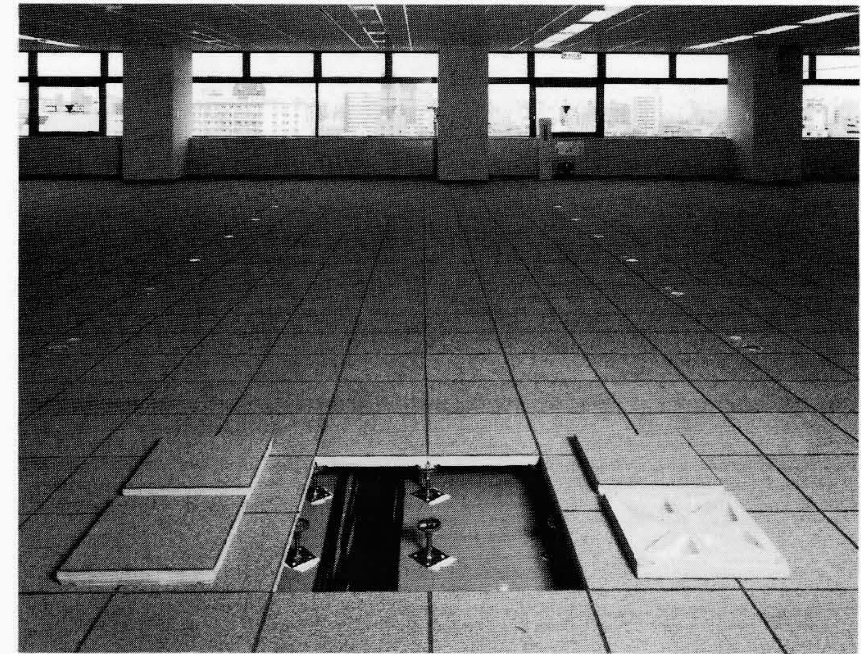
図8 フリーアクセスフロアのオフィスでの適用状況 コンクリート系パネルを用いたコンフロアC-450で布設されたオフィス床を示す。
