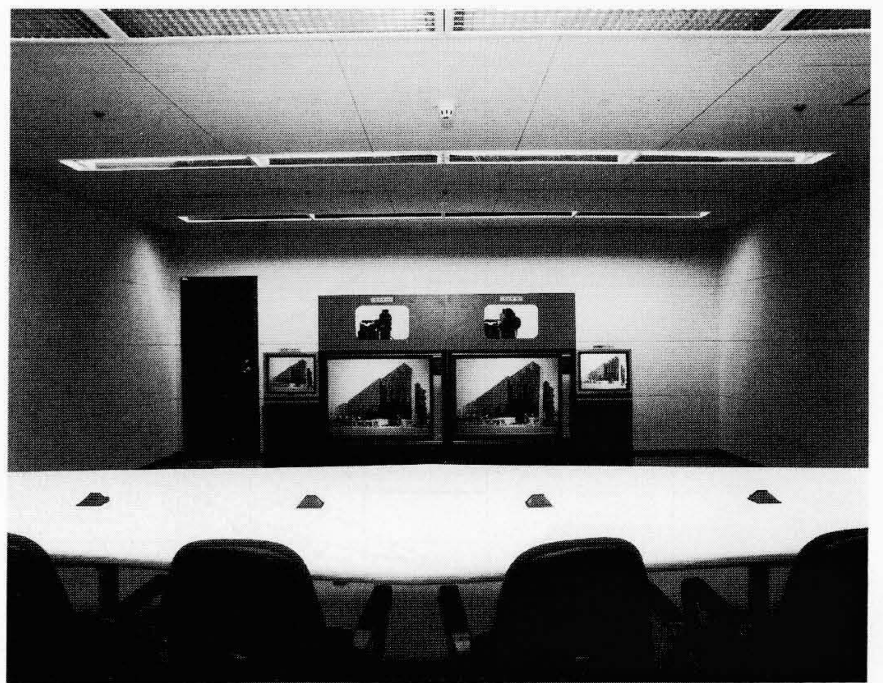
図10 テレビ会議室の照明設備 テレビ会議室だからといって特異性を出すことなく、すっきりした配置でありながら作業面1,000lx映り込み防止など果たされている。
