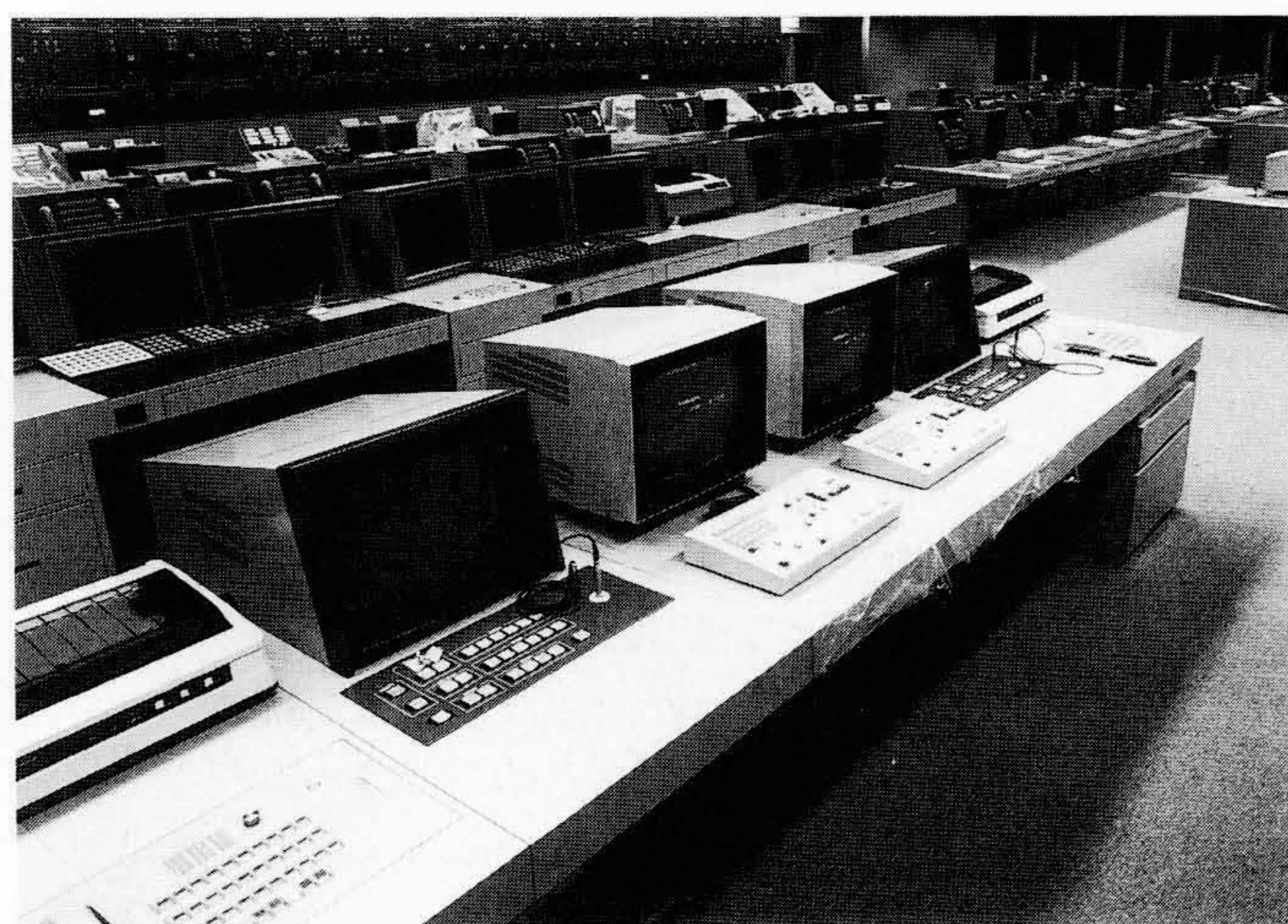
図2 新指令室 マンマシンインタフェースの中心はCRT(Cathode Ray Tube)である。
