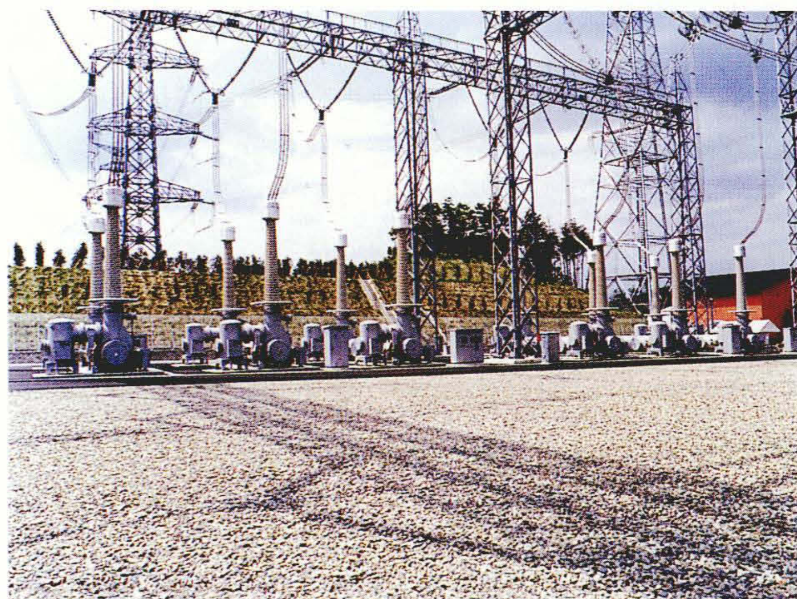
東京電力株式会社新今市開閉所納め550 kVセミガス絶縁開閉装置
