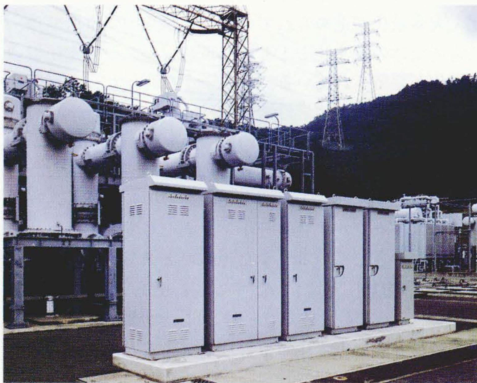
屋外分散形全デジタル制御・保護システム
