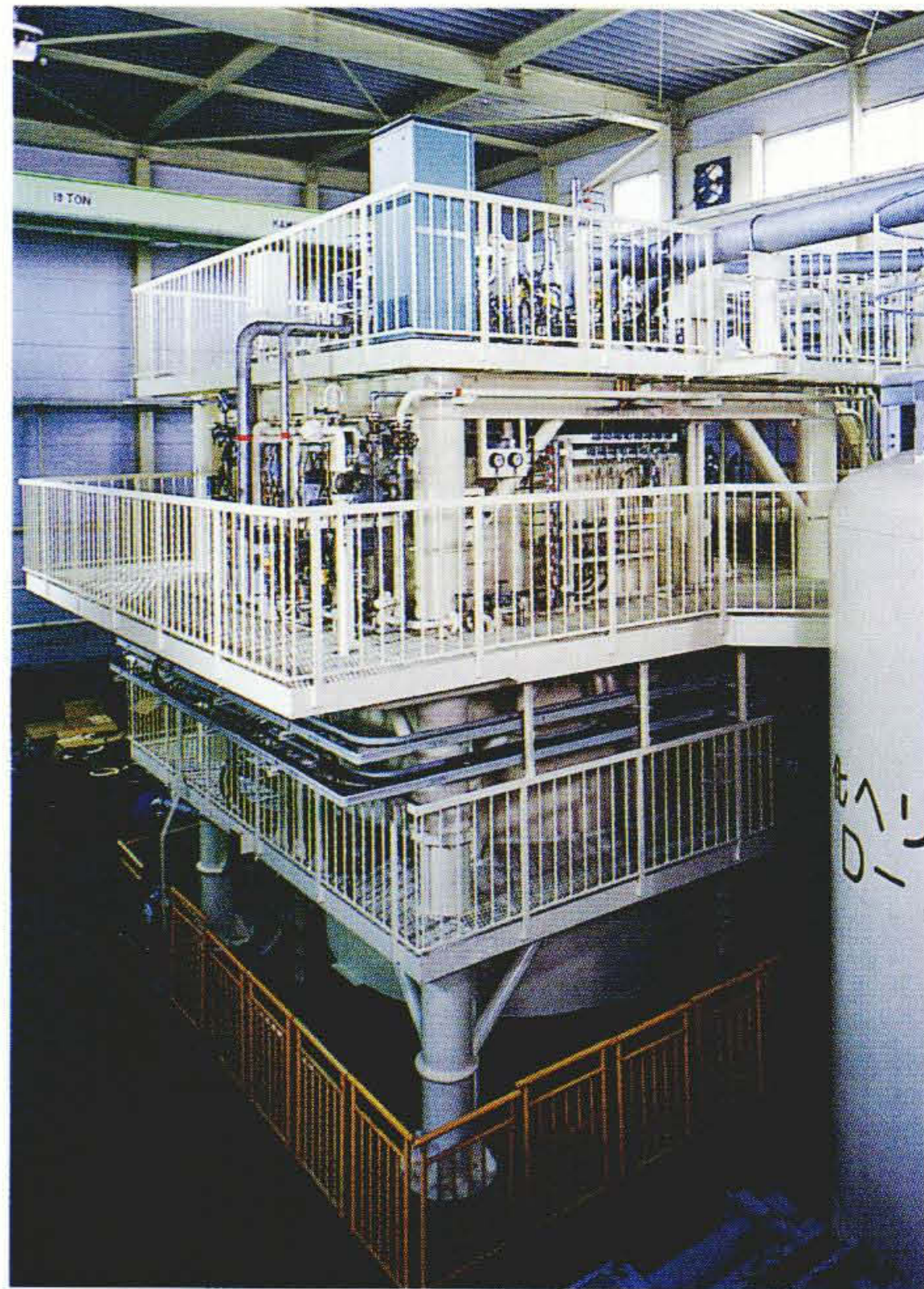
文部省高エネルギー物理学研究所納め 4,000 Wヘリウム冷凍機の外観
