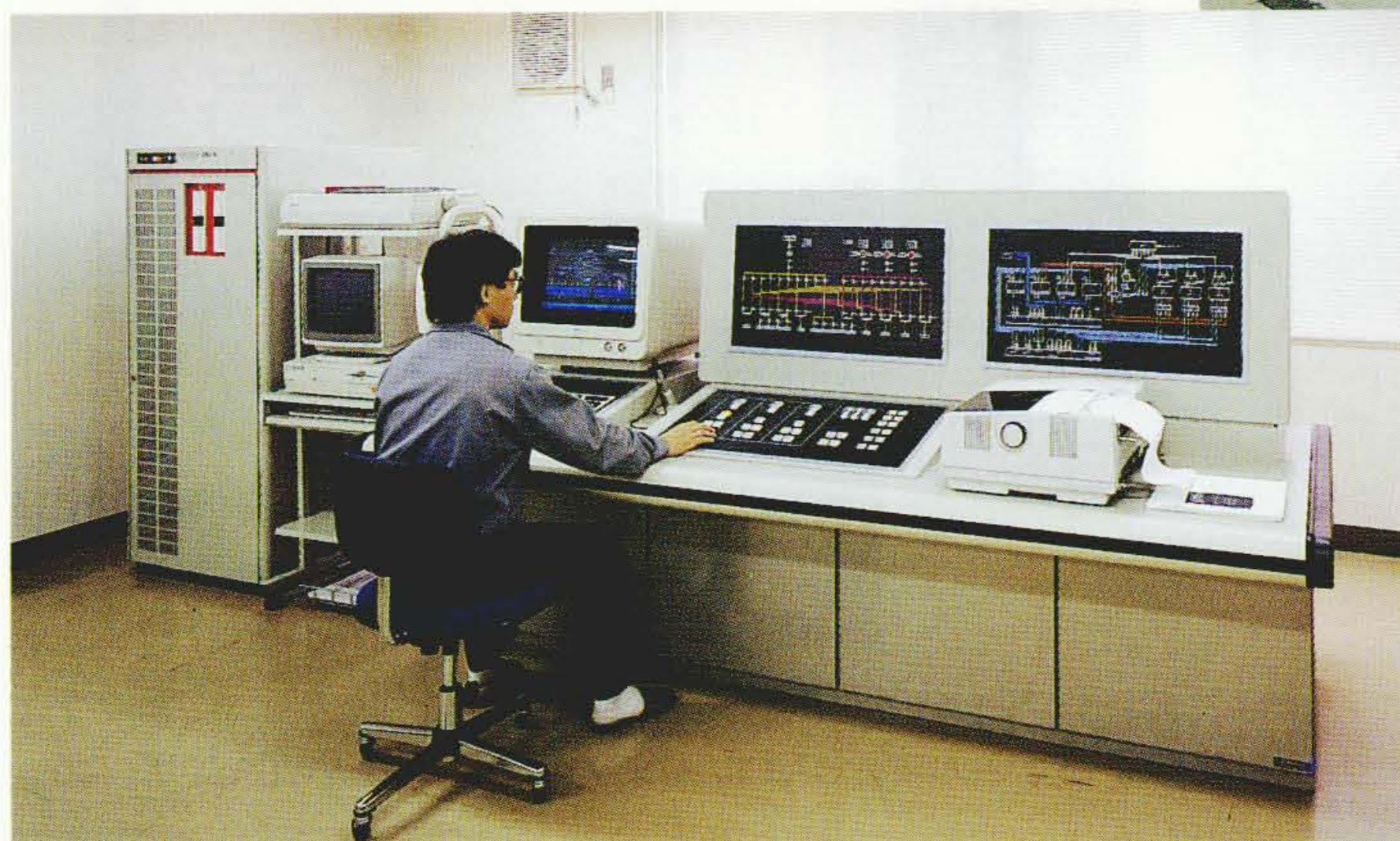
中央監視装置
