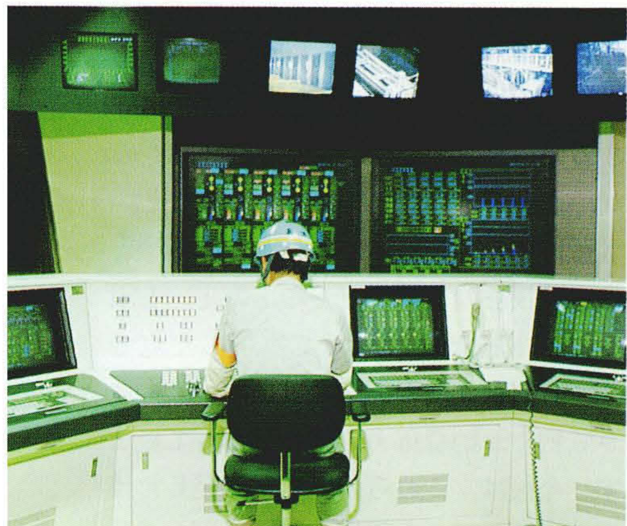
大画面、CRTによるヒューマンフレンドリーな運転室
