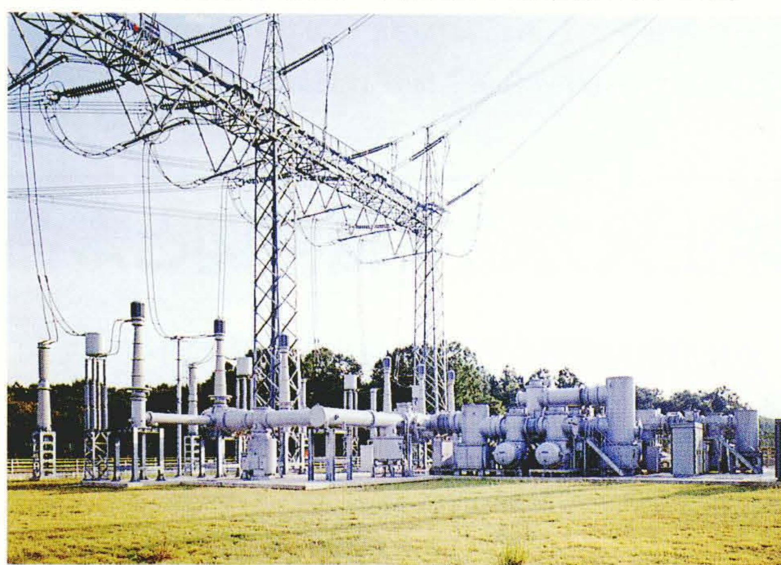
新坂戸変電所全景
