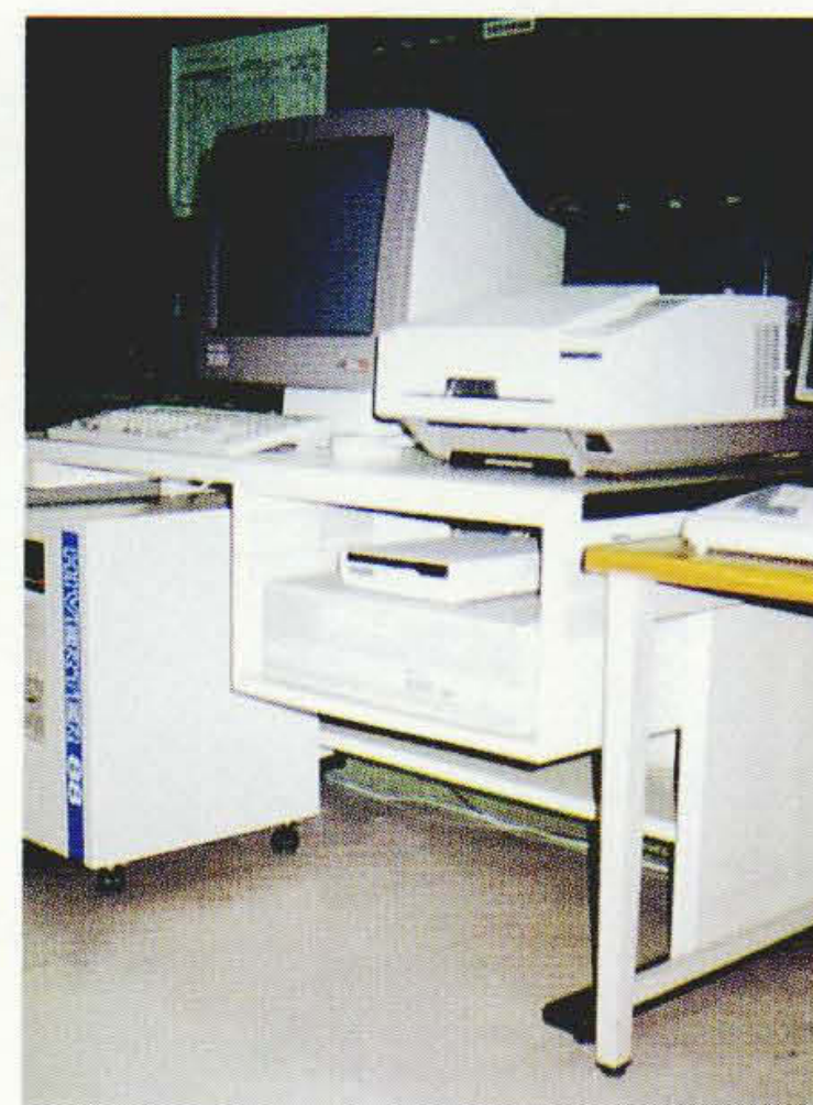
遠方監視装置
