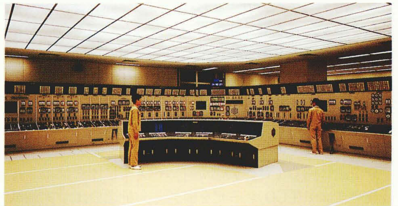
中央制御室設置中央監視盤(手前)
