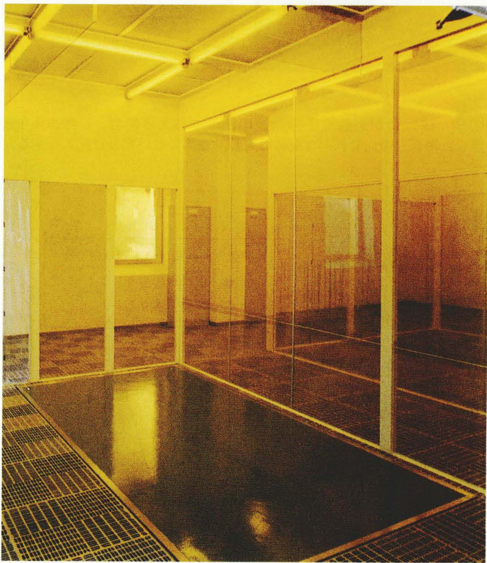
図7 クリーンルーム内設置例 除振床は、写真に示すようにフリーアクセス部と分けて設置される。
