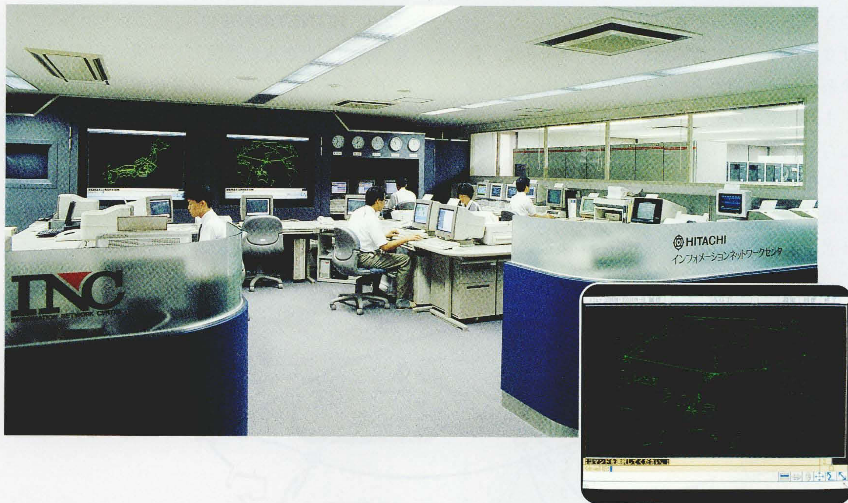
中央通信コントロールセンタ監視室と監視画面 日立製作所大森第二別館内に設置された国内・海外全体の監視室と、オペレーターにわかりやすい統括網監視画面(右下)を示す。
