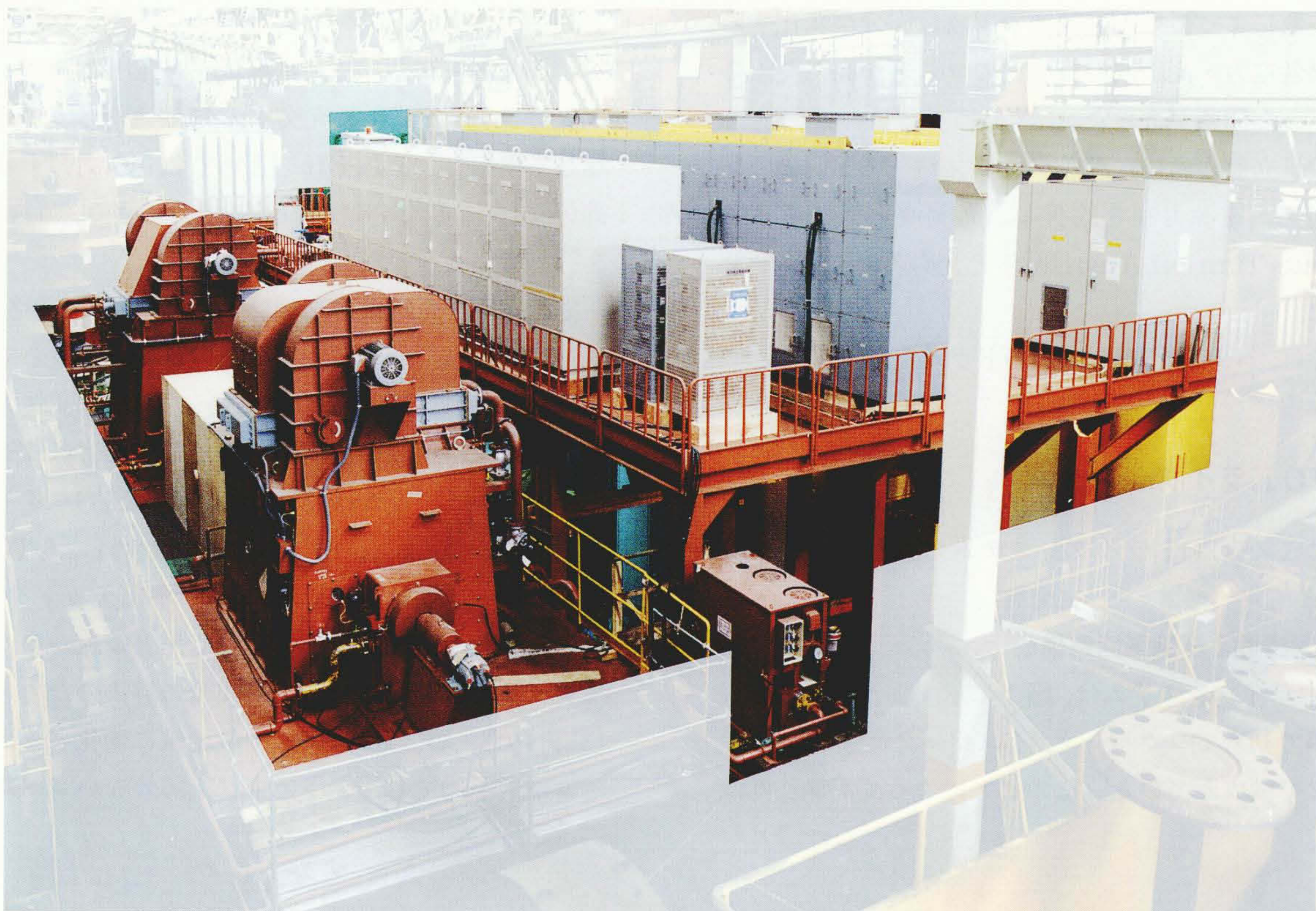
GTO(Gate Turn off Thyristor)ドライブシステム組み合わせ試験の全景 株式会社淀川製鋼所および川崎製鉄株式会社納めの二つのドライブシステムを、電動機および負荷機として運転し、性能評価試験を実施した。
