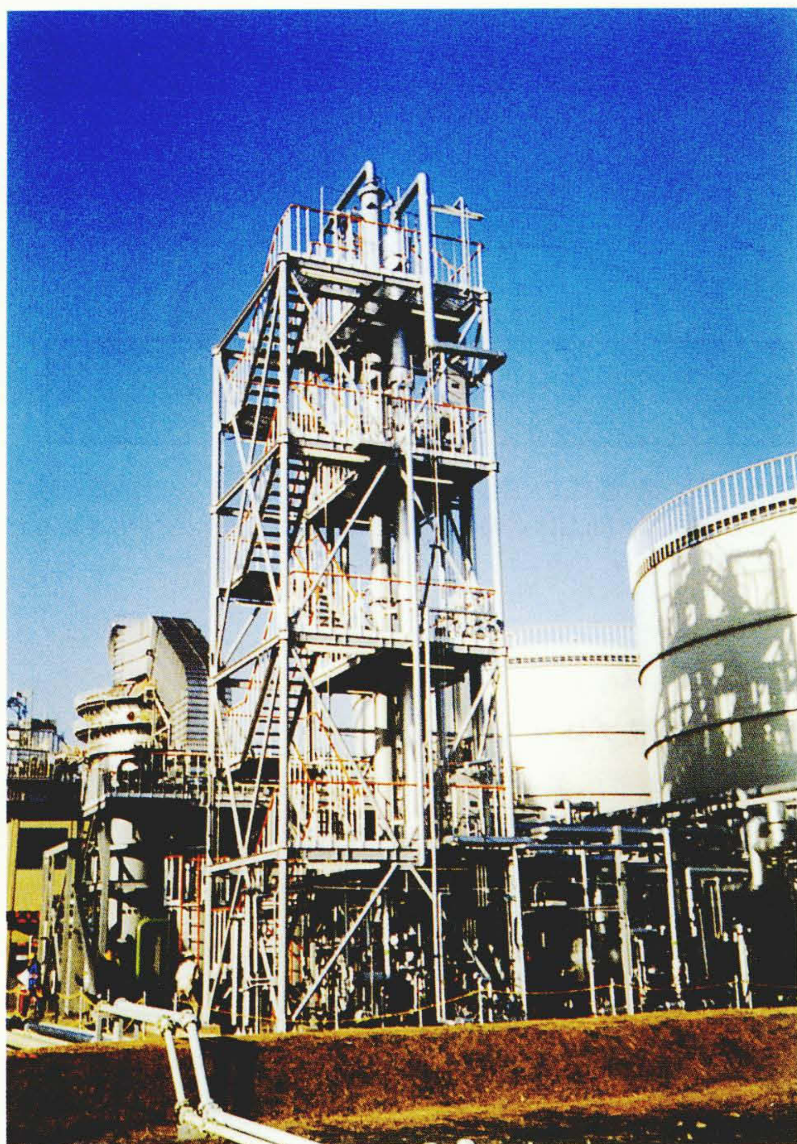
図2 吸収法パイロットプラント 東京電力株式会社横須賀火力発電所内で試験中の排ガス処理量1,000 m 3 N/hパイロットプラントの外観を示す。
