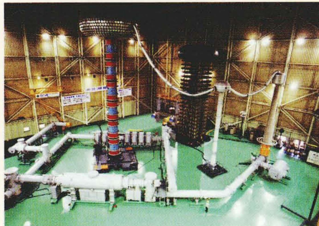
1,000 kVガス絶縁開閉装置
