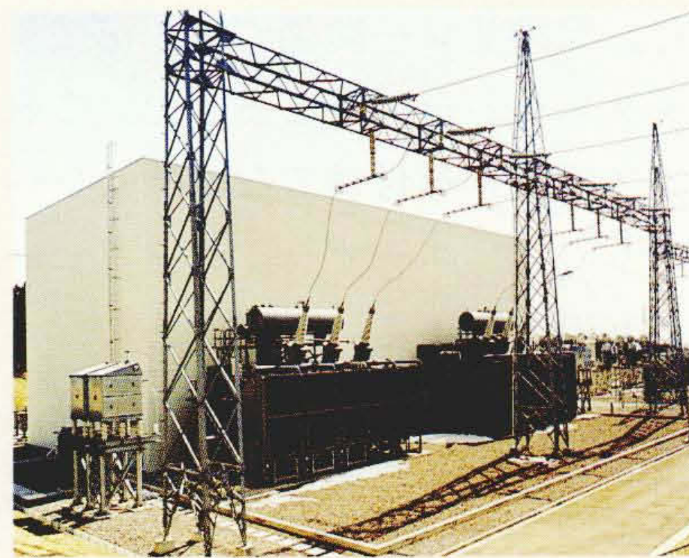
交直流変換設備
