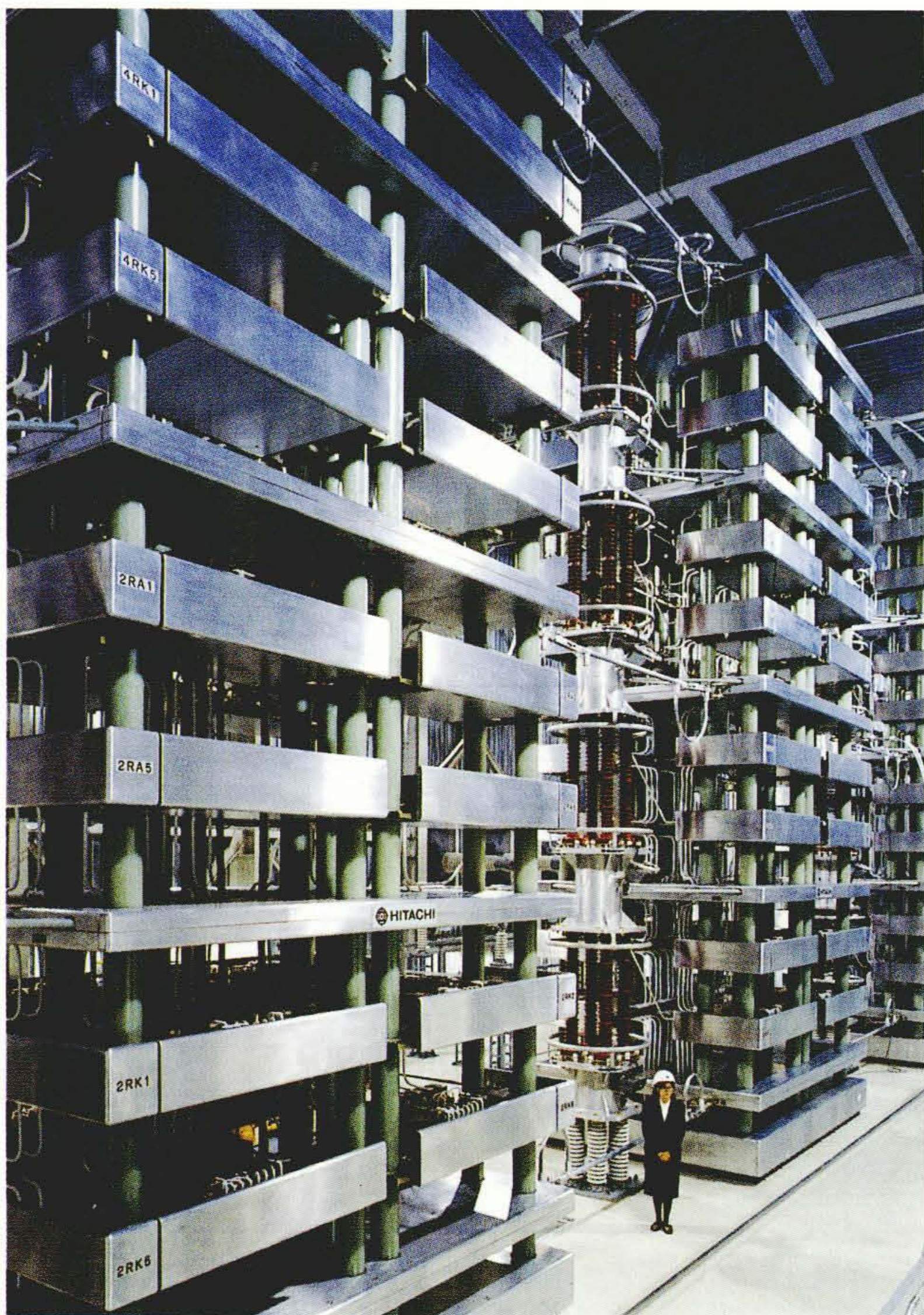
図6 サイリスタバルブの現地据付け状態
