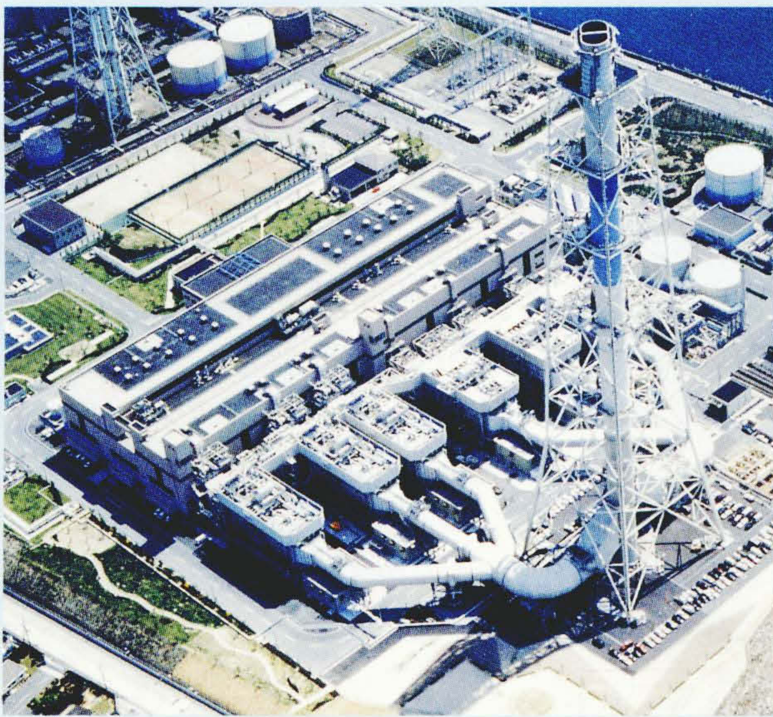
関西電力株式会社姫路第一発電所6号機
