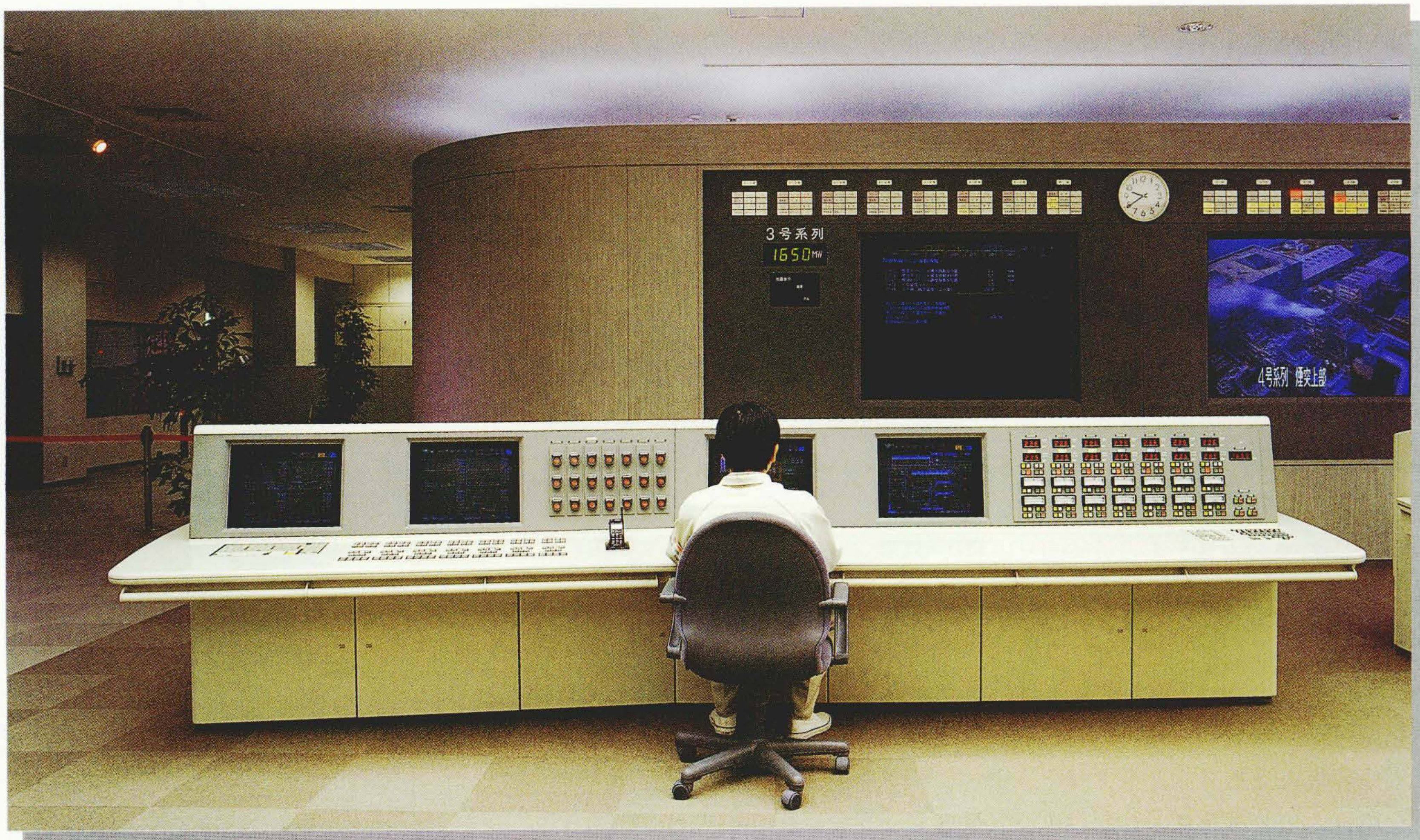
中部電力株式会社川越火力発電所 3号系列の中央操作室
