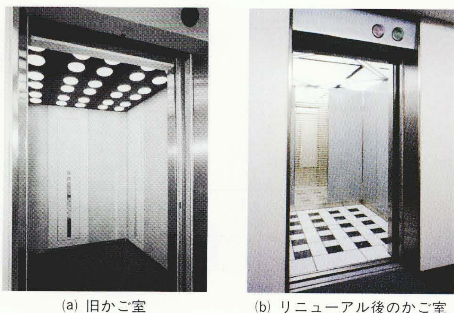
図7 新宿三井ビルのリニューアル事例 かご室天井には斬新なデザインを採用し、インテリジェントビルにふさわしいものとしている。
