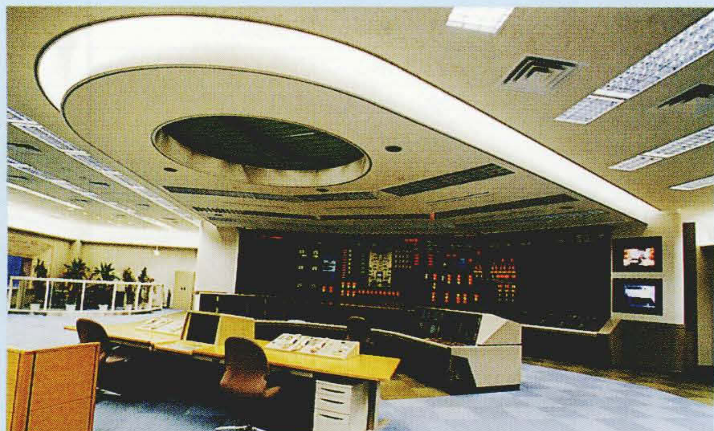
東京電力株式会社柏崎刈羽原子力発電所 7号機中央制御盤
