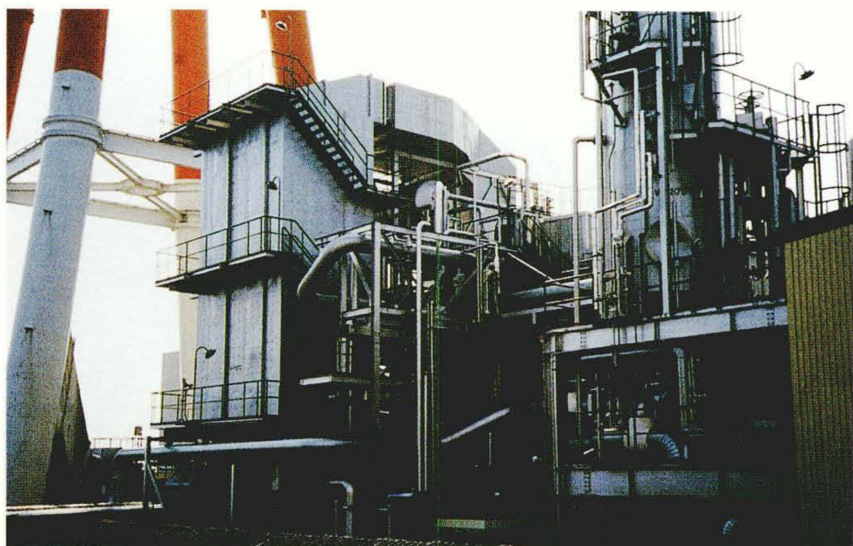
昭和四日市石油株式会社四日市製油所第8号発電設備
