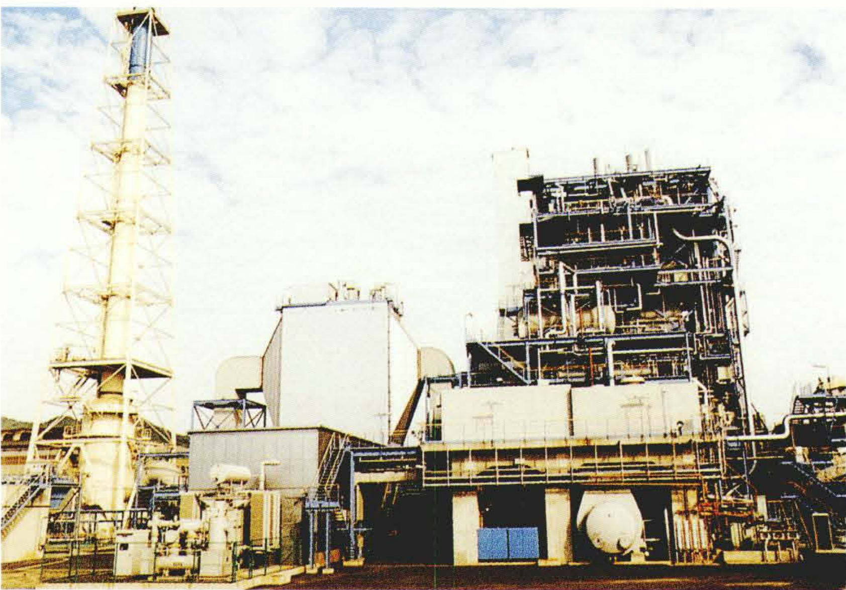
新日本製鐵株式会社ステンレス事業部光製鐵所 第2号発電設備
