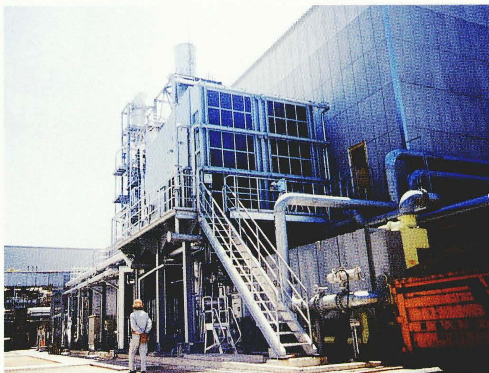
トヨタ自動車株式会社下山工場第2発電所 ガスタービン コンバインド サイクル自家発電設備
