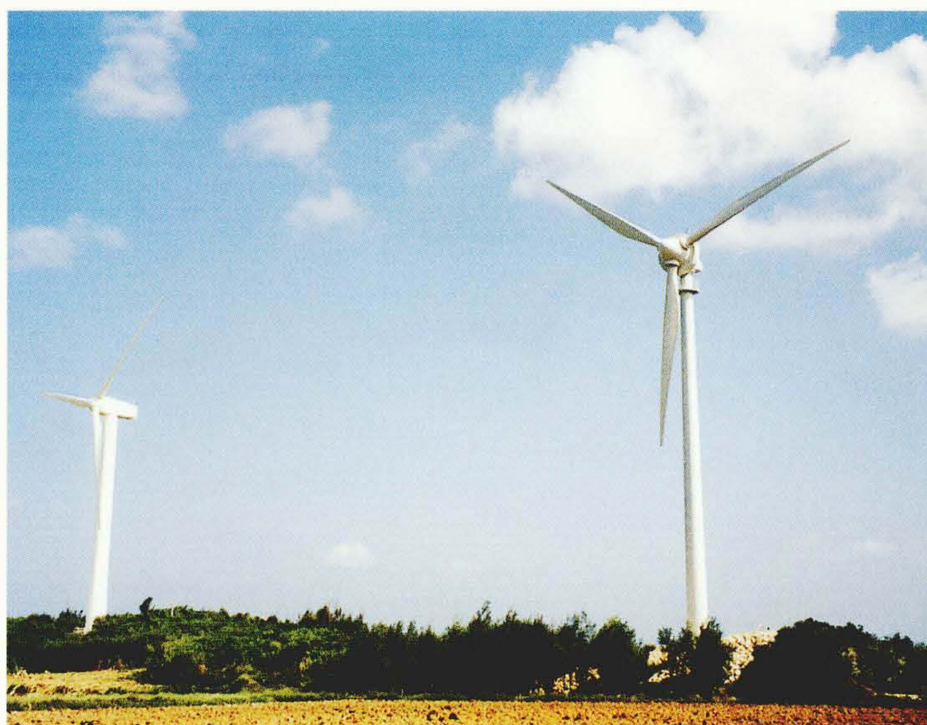
宮古島向け600 kW(左)、500 kW(右)風力発電設備
