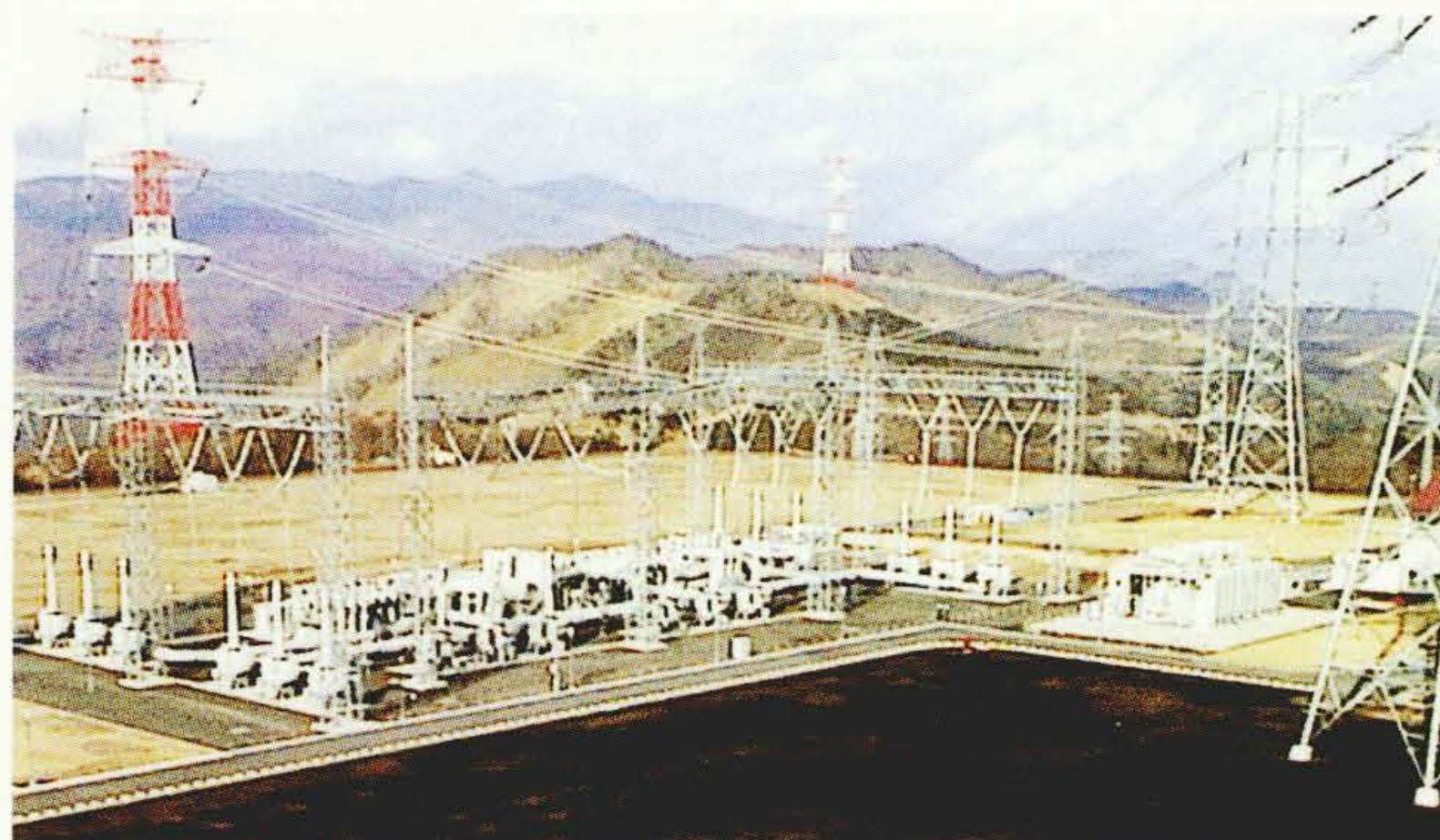
東京電力株式会社東群馬変電所納め500 kV変電機器
