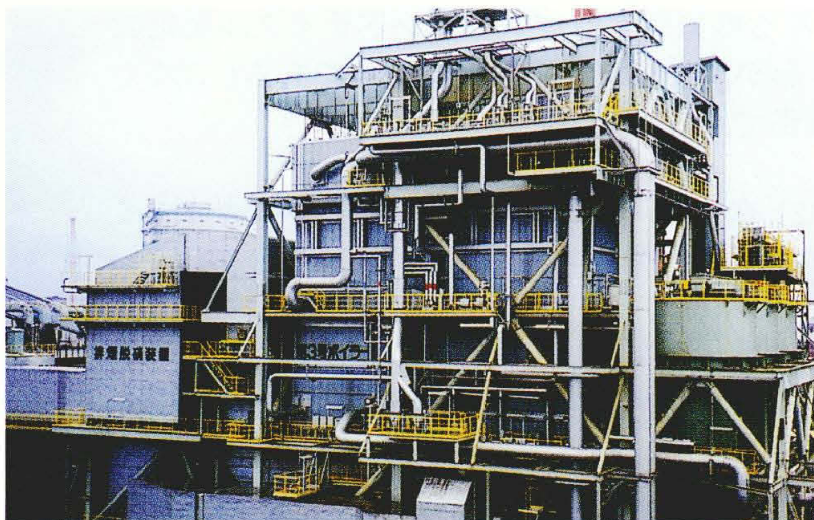
新日本製鐵株式会社八幡製鐵所戸畑発電所納め 第3号発電設備
