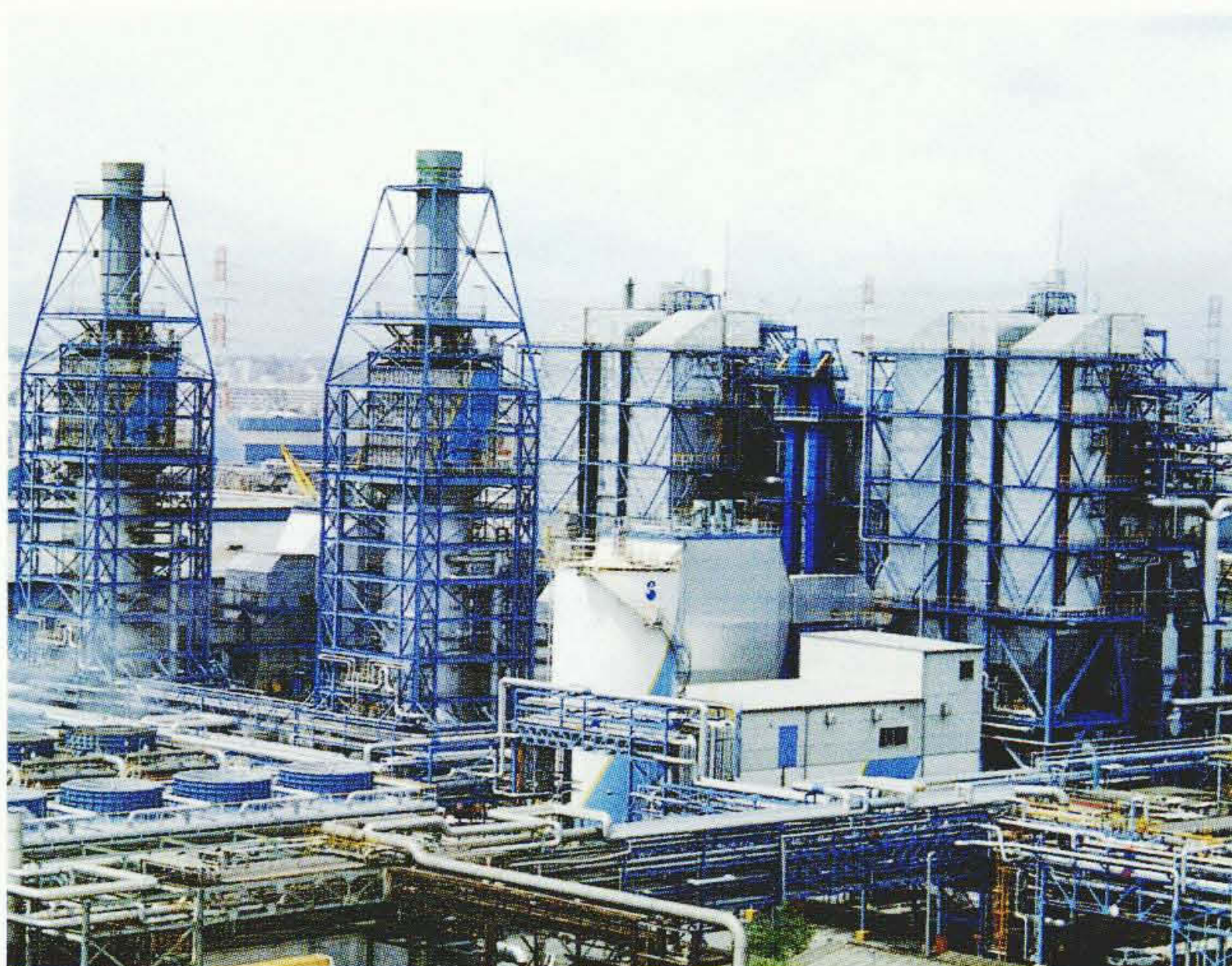
昭和電工株式会社川崎工場納め4号発電設備(手前が4号機)
