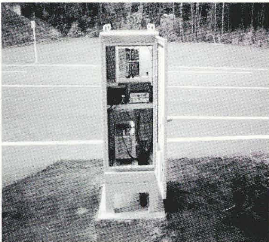
図8 DSRC無線基地局の内部
