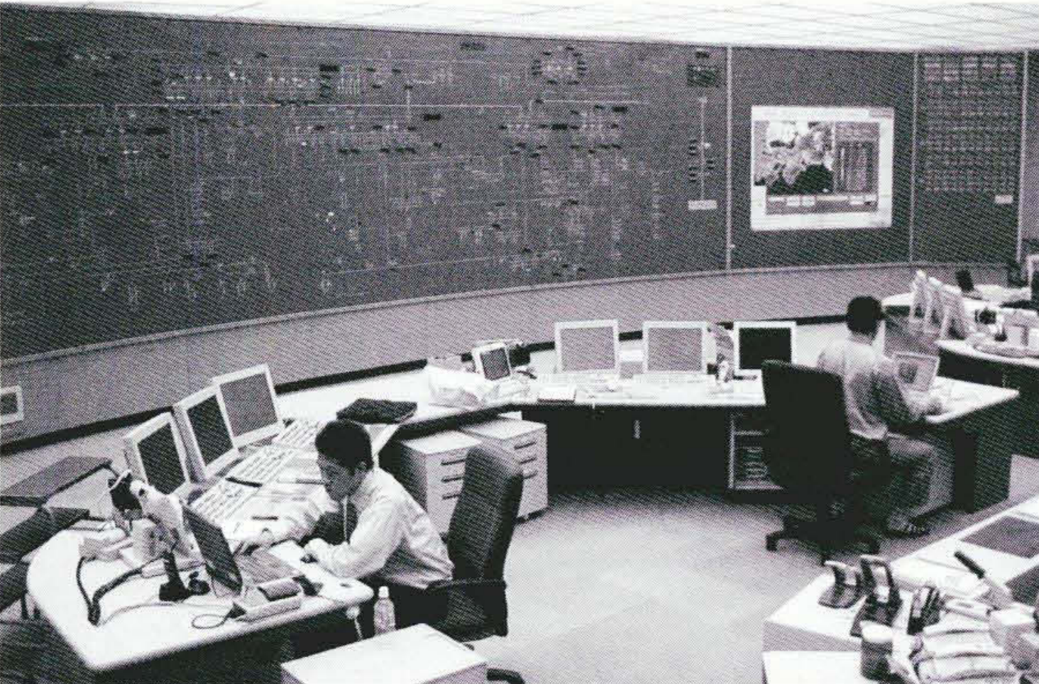
中部電力株式会社岐阜給電制御所の制御室
