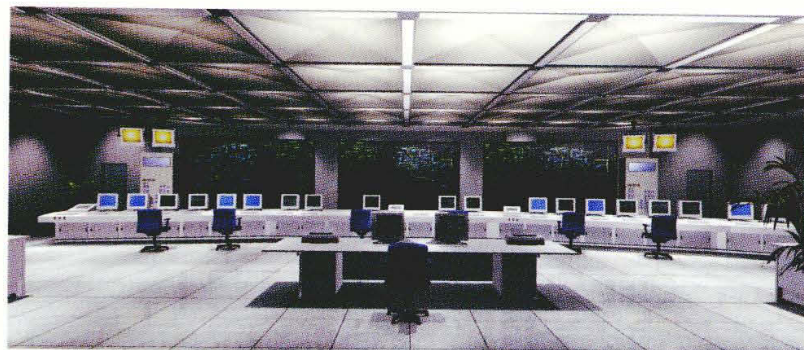
新時代型の総合監視制御を導入した中央制御監視室内部
