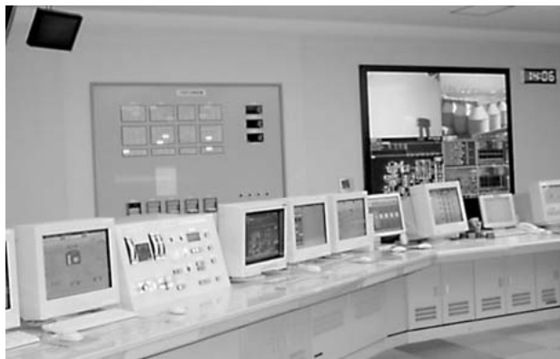
図3 神戸神戸発電所2号機の中央操作室
