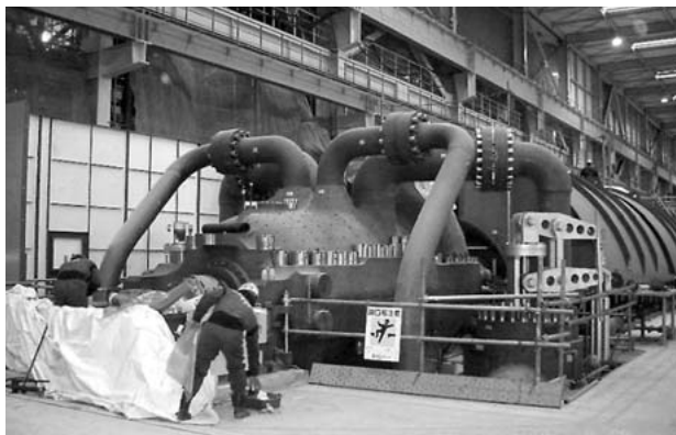
図4 主蒸気リード管と高温再熱蒸気管の設定状況
