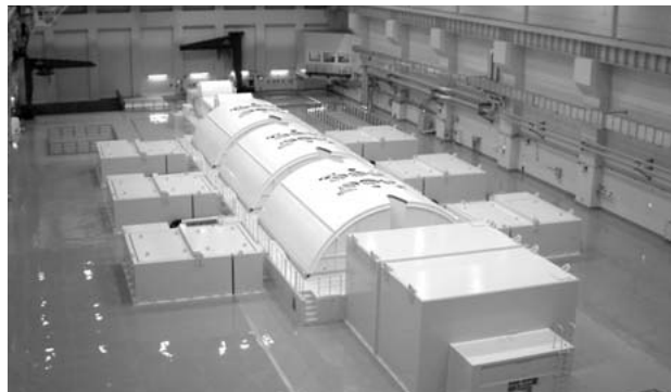
図1 蒸気タービンの全景
