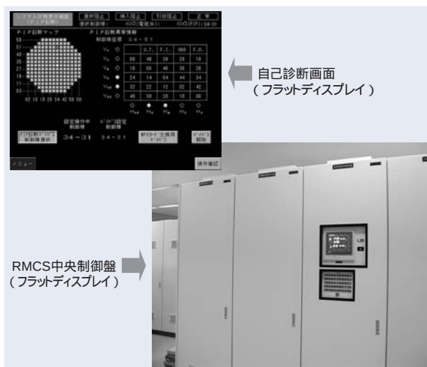
図2 東京電力株式会社柏崎刈羽原子力発電所第4号機の更新後
