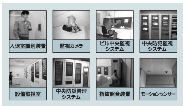
図6 セキュリティ対策のイメージ エリアのセキュリティレベルに応じた対策を講じている。
