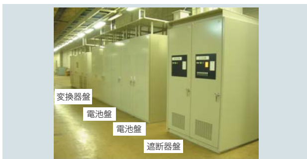
図9 神戸市交通局納め蓄電池式再生電力吸収装置の外観 年間385 MWhの省エネルギー効果を確認した。
