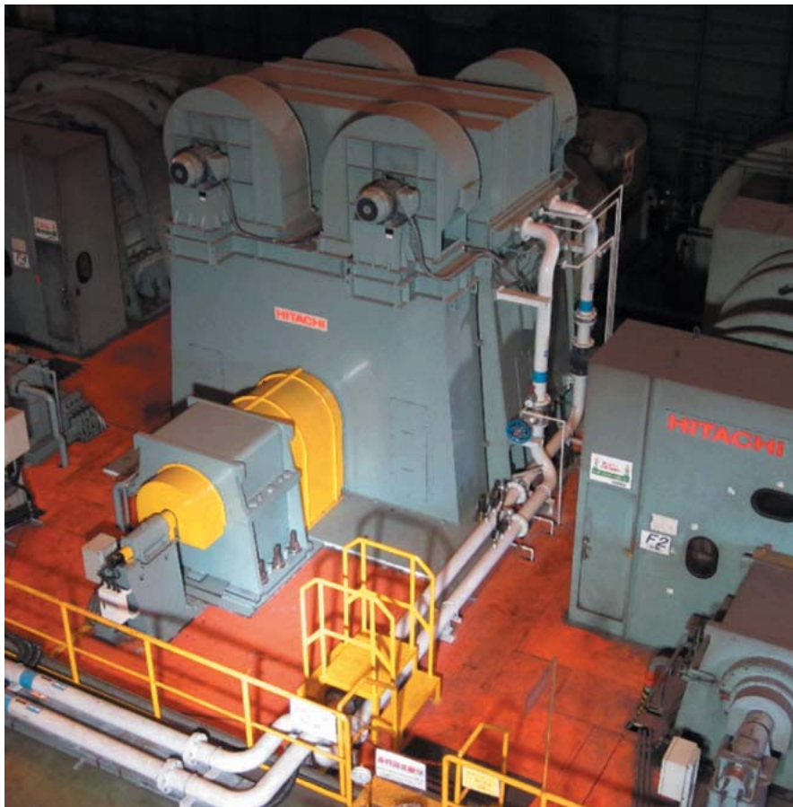
1 JFEスチール 東日本製鉄所京浜地区熱延仕上げNo.3スタンド圧延機用電動機
