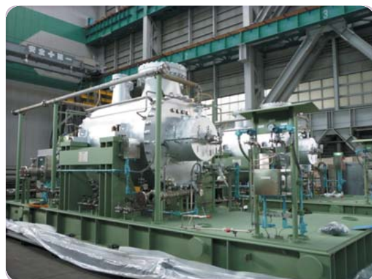
20 サウジアラビア・Saudi Aramco社マニファガス処理プラント大型圧縮機
