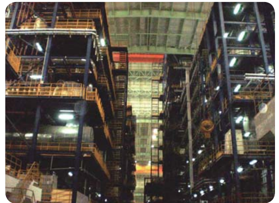
2 中国・GJSS CAL炉設備
