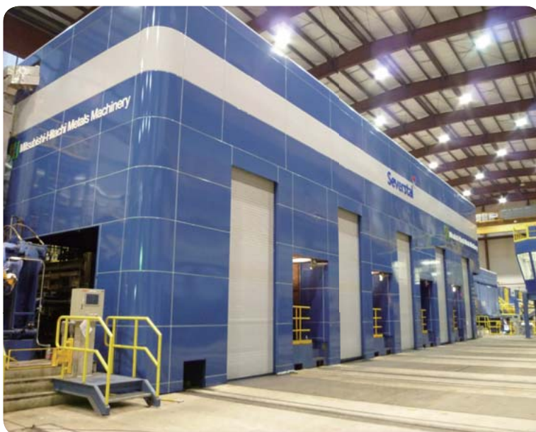
1 連続酸洗冷間圧延設備「PLTCM1」
