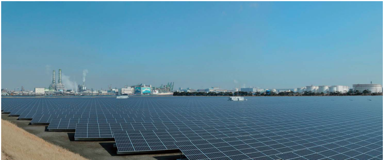
大規模太陽光発電システムの普及拡大への取り組み（東京電力株式会社扇島太陽光発電所）
