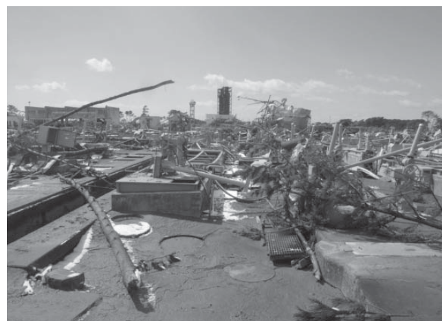
図5 | 被災直後の最初沈殿池設備（南蒲生浄化センター）
