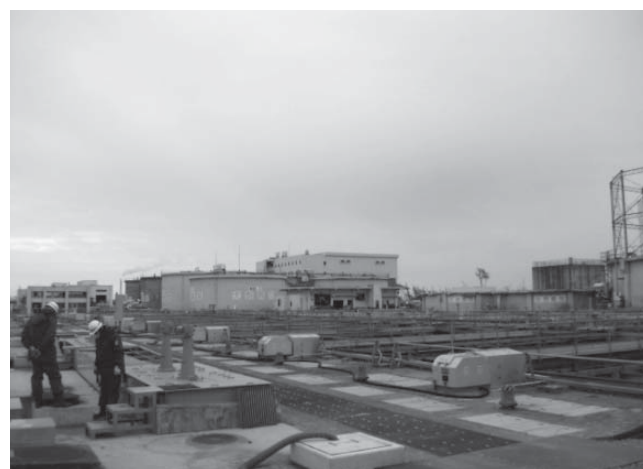
図6 | 仮復旧後の最初沈殿池設備（南蒲生浄化センター）
