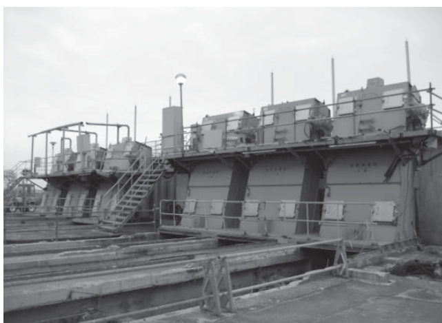
図4 | 仮復旧後の沈砂池設備（南蒲生浄化センター）
