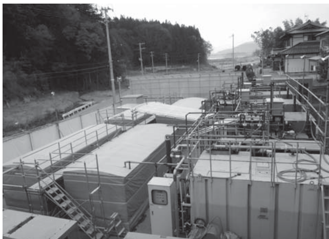
図2 | 2011年12月20日現在の平膜設備全景（陸前高田浄化センター） 右手に5基の平膜設備、左手に沈砂池、流量調整槽（仮設用土木水槽）、奥に汚泥脱水設備を配置した。冬季対策として保温している。
