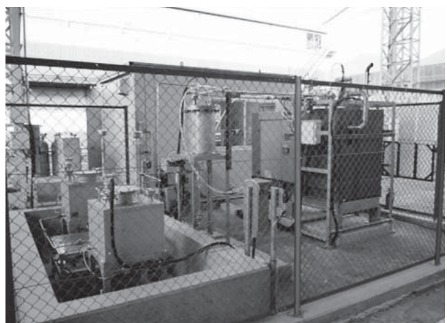
図5 | 40 kW級循環型再生可能エネルギー実証実験プラント 40 kW級の実証実験プラントを茨城県日立市に設置し、循環型再生可能エネルギーシステムの実用化に関する開発を進めてきた。
