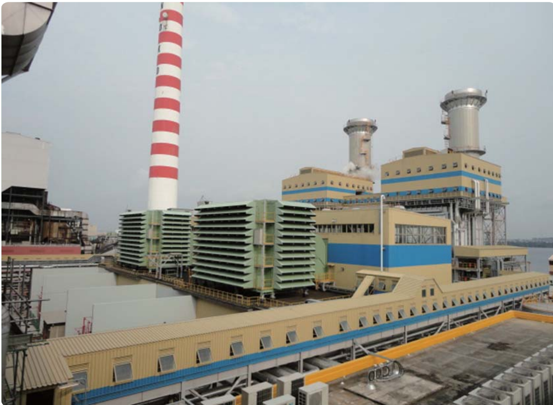
4 Senoko Energy Pte Ltd. セノコ発電所ステージII リバリングプロジェクトのプラント全景
