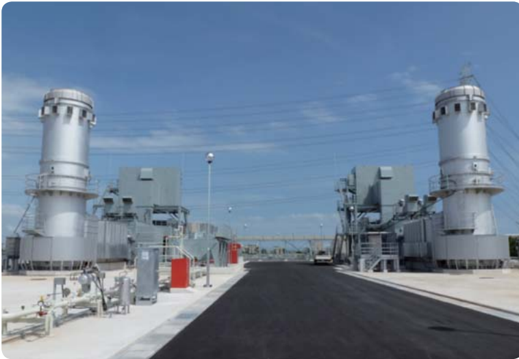
3 関西電力姫路第一発電所のガスタービン発電設備1号機および2号機の全景
