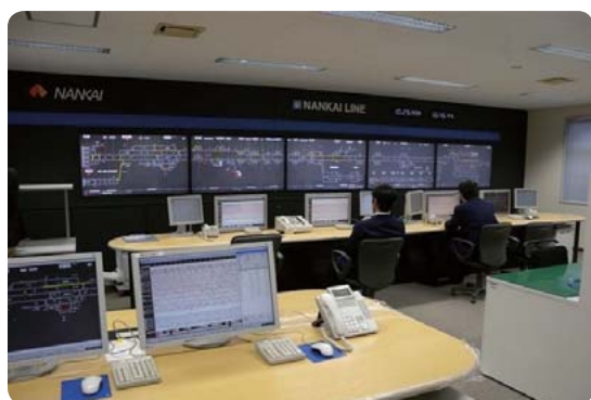
1 南海電気鉄道 南海線列車運行管理システムの新指令所運行表示盤と指令卓
