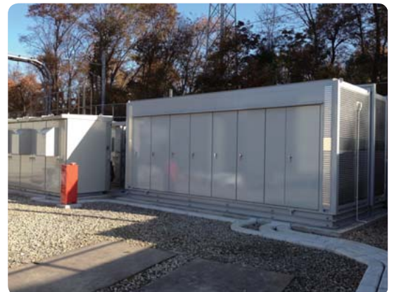
9 東日本旅客鉄道 青梅線拝島変換所に納入した電力貯蔵装置の外観〔蓄電池盤(左)、チョップ装置(右)〕
