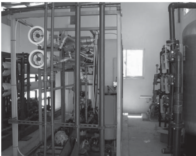
図6 | ツバル向け海水淡水化装置
