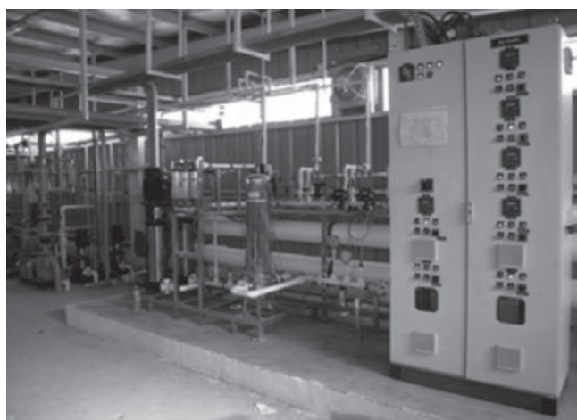
図8 給水処理設備
