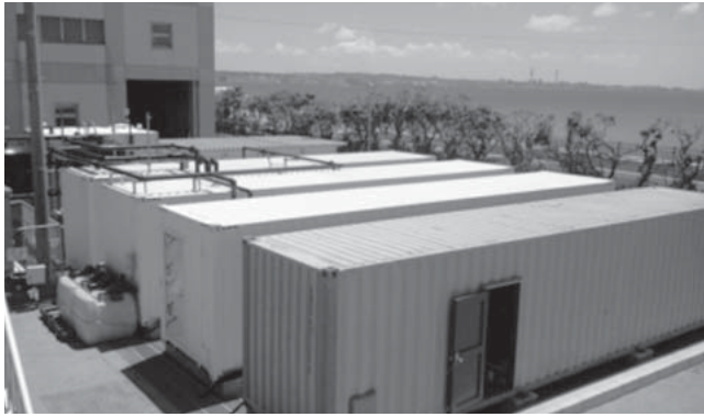
図2 | Mega-ton Water System パイロット試験設備 沖縄県企業局の海水淡水化施設内に設置したパイロット試験設備の外観を示す。
