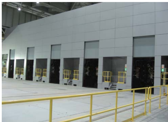
1 メキシコ・Ternium S.A. de C.V.社 連続酸洗冷間圧延設備
