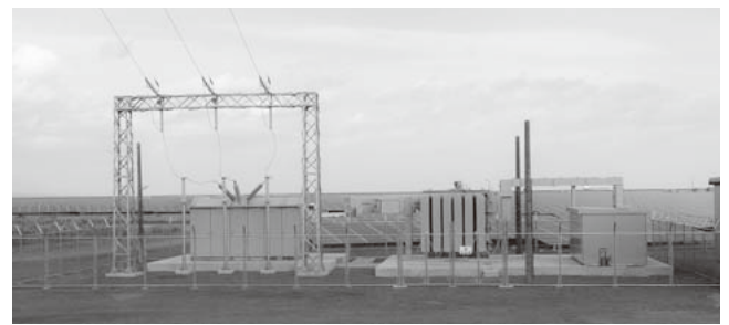
図3 | 特高変電所（連系変電所）
