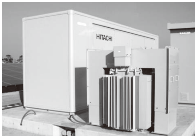
図7 SuperアモルファスX ceシリーズの設置状況
