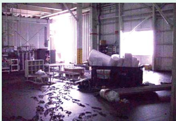
被災した工場
