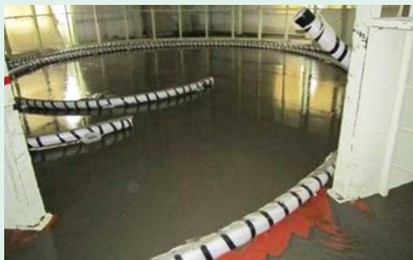
冠水したケーブル
