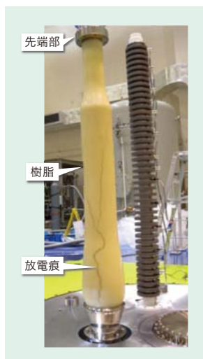
図8 | 高電圧ケーブルのケーブル端部で放電が発生
