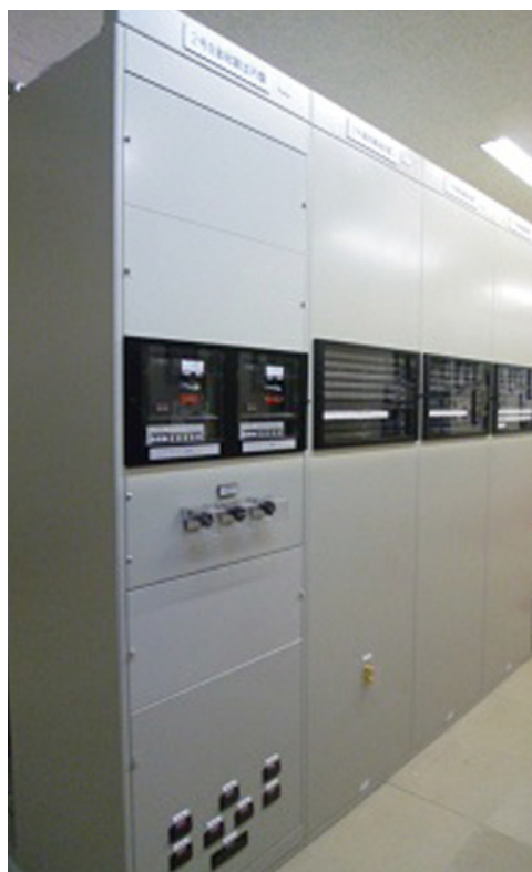
4 更新後の保護継電器盤
