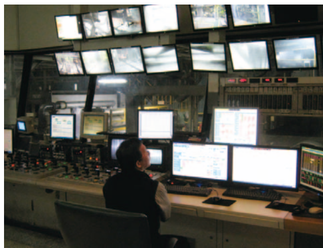
3 台湾CSC社2CAL 出側運転室操作卓
