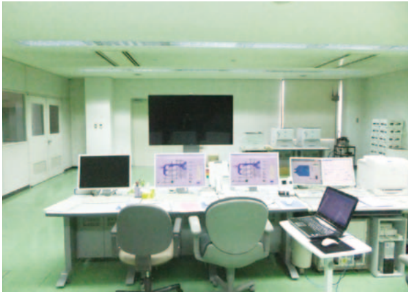
5 広島県沼田川浄化センター 監視制御システム
