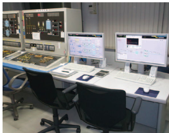
2 久喜市上下水道部吉羽浄水場 中央監視制御装置
