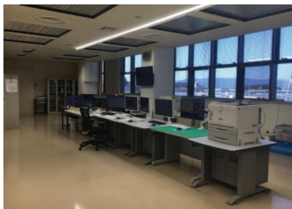
3 一宮建設事務所日光川上流浄化センター 中央監視制御システム
