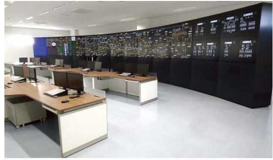
4 沖縄電力 バックアップ自動給電システム
