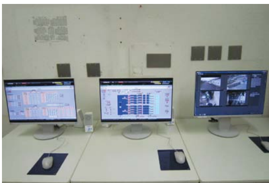
3 広島市下水道局 宇品ポンプ場の遠方監視システム
