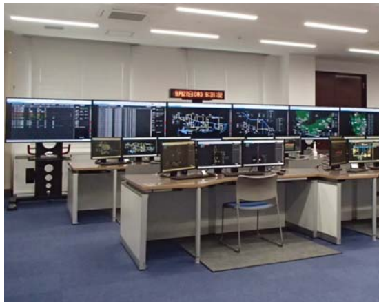
4 東北電力 水力運用センター南部システムの大画面表示装置と監視制御卓
