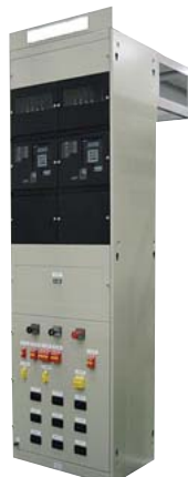
14 位相調整器用デジタル保護リレー装置
