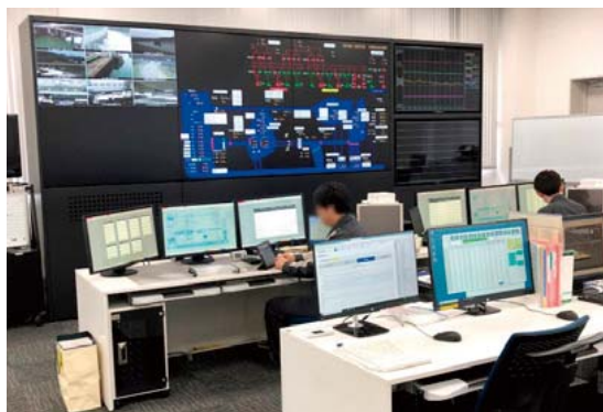
5 運用開始後の水力総合監視制御システム
