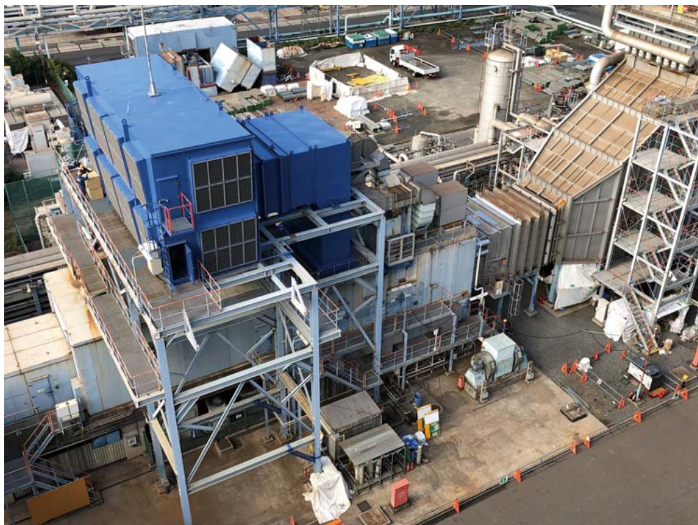
1 ガスタービン設備全景 (リプレース中)
